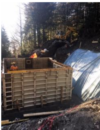
Chambre mise en charge
