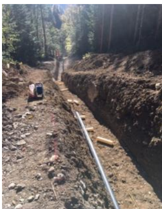
Conduite EP pression
